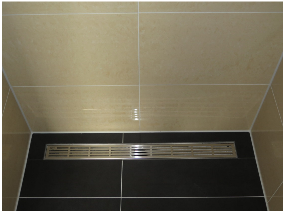
Dusche mit Einlaufrinne Abbildung 10
