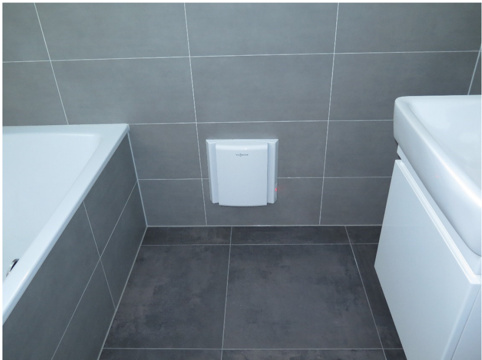
Dezentraler Lüfter mit Wärmerückgewinnung Abbildung 36
