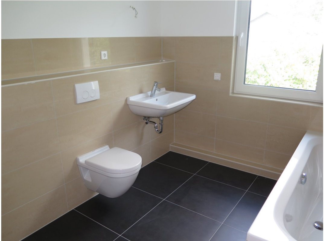
Wand- und Bodenfliesen im Bad, Sanitäröbekte Duravit Serie Starck 3 in weiß Abbildung 5
