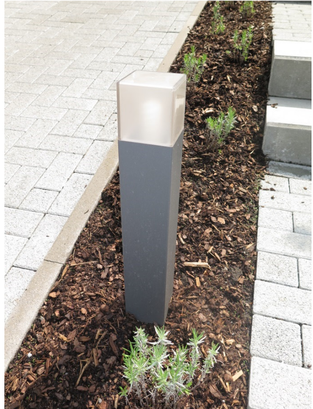
Außenbeleuchtung als Pollerleuchte Abbildung 23
